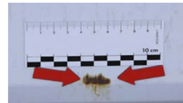
Arañazos con oxidación, depósitos químicos o de otro tipo que no se pueden limpiar
