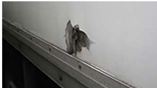
Paneles laterales de madera: Soporte de madera deteriorado \geq 20 cm
