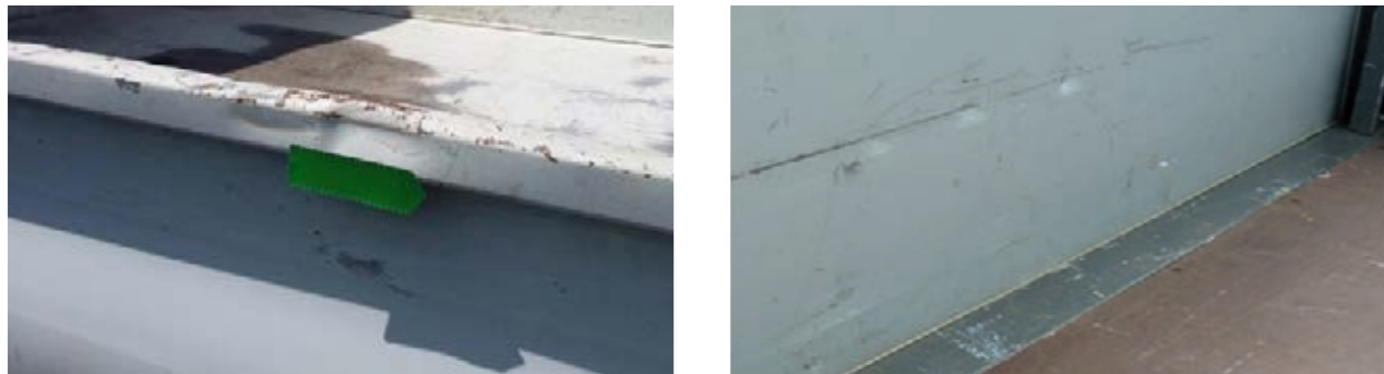
Ligeros arañazos, deformaciones del conducto con un tiempo de reparación \leq 0,5 h
