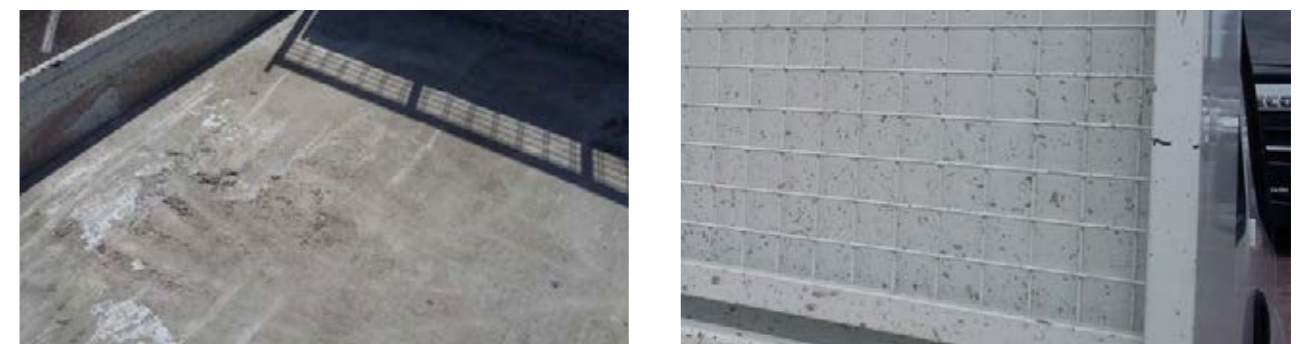
Residuos de hormigón o de productos químicos que cubren \geq 1/4 de la superficie de la tolva
